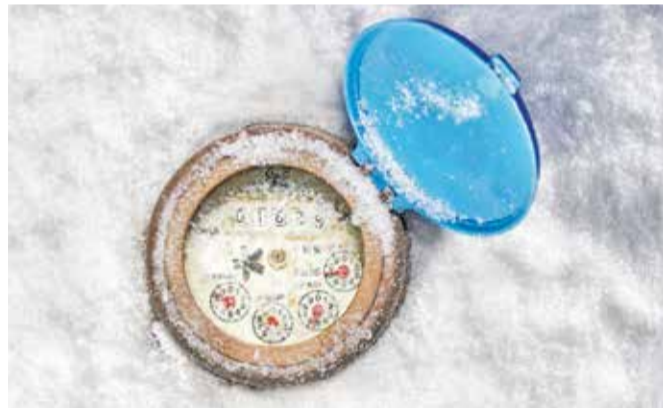
Posledice nizkih zimskih temperatur se kažejo tudi na pogosto poškodovanih vodomeroih. / FOTO: KOMUNALA KRANJ
